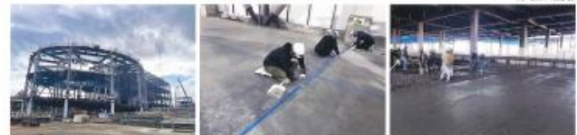
鉄骨建方 上層CCB工法充填材注入 床コンクリート打設工事
