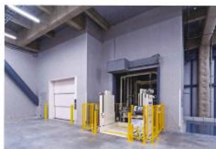
垂直搬送機・荷物用EV
